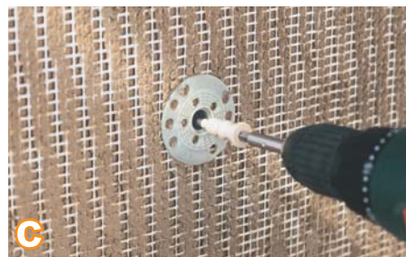
c Тарелка дюбеля после прижатия должна быть утоплена в свежий раствор. Непосредственно после дюбелирования следует нанести второй слой раствора RAS (свежее на свежее), доводя толщину армирующего слоя до 7-10 мм
