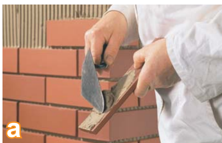
a После полного затвердевания армирующего слоя (технологический перерыв не менее 7 дней) можно приклеивать керамическую плитку. Наклеивание производится комбинированным нанесением клеевого материала на основание и на плитку (Buttering-Floating). На затвердевший армирующий слой наносится с помощью зубчатой терки (зубцы 8 x 8 мм или 10 x 10 мм) слой клеевого раствора толщиной примерно 3-4 мм. На тыльную сторону плиток наносится сплошной слой клеевого раствора толщиной примерно 1 мм
