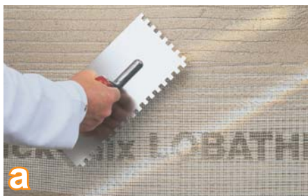
a Вдавливание по всей поверхности армирующей сетки QMS 145 или QMS 165 в шпаклевочный раствор quick-mix RAS на толщину слоя не менее 7 мм
